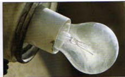
A kiégett hagyományos égő (a halogén is) gyakorta a kismegszakítót is leoldja. A pillanatnyi rövidzár után viszont a megszakító nyugodtan visszakapcsolható, a zárlat oka magától megszűnik.
