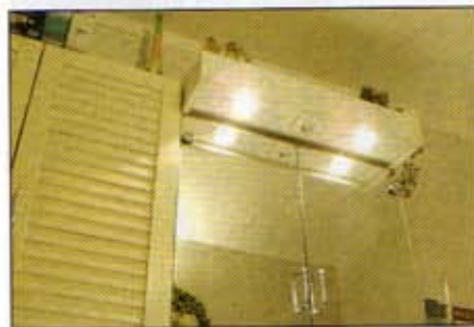
Beépített halogén rendszer fürdőszobai szekrényben. Az égők a felső zárt szekrényrekeszbe szellőznek. Itt kapott helyet a trafó is.
